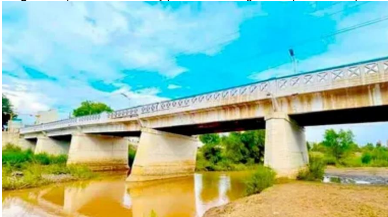
Imagen 6. Aspecto de las lluvias y puente del Río Aguanaval previo al colapso
