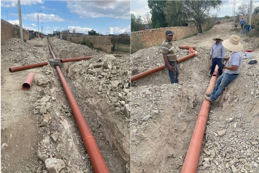
Alcantarillado Noria del Boyero
